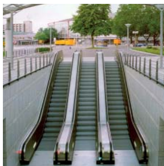
Установка под открытым небом
